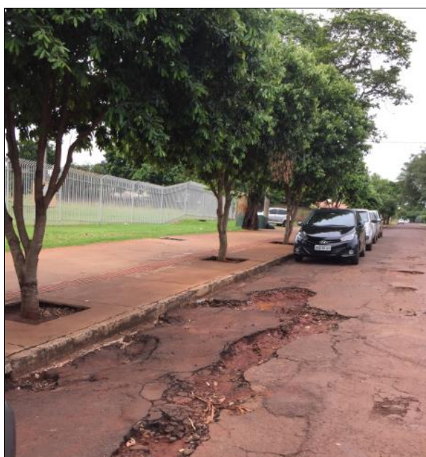
Imagem 5 – Cratera no pavimento em rua da zona urbana Norte da cidade de Dourados decorrente das chuvas
