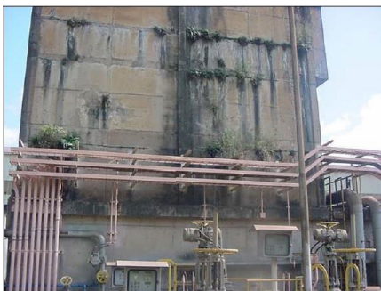
Figura 6 - Crescimento de raízes de plantas em fendas de concreto
