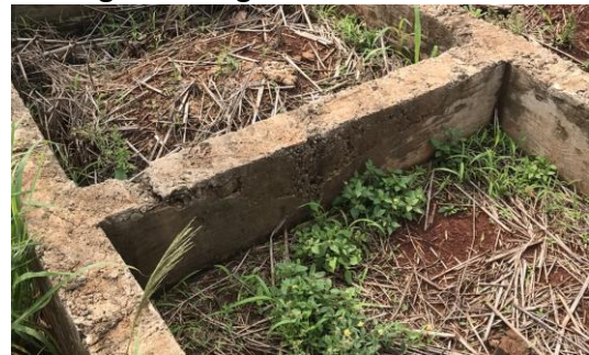
Figura 16 - Bicheiras ou ninhos de concretagem na viga baldrame
