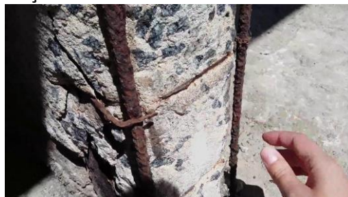
Figura 1 - Armadura do pilar corroída com formação de crosta
