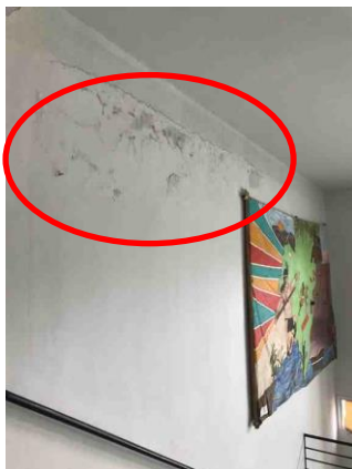
Figura 18 - Parede manchada e com pintura descascando conforme indicado
