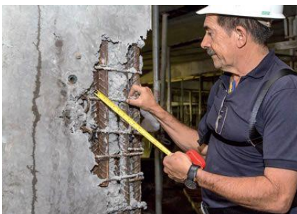
Figura 5 - Bicheira causada por espaçamento de armaduras insuficiente
