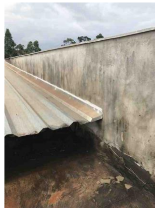
Figura 23 - Deslocamento do concreto da laje de cobertura
