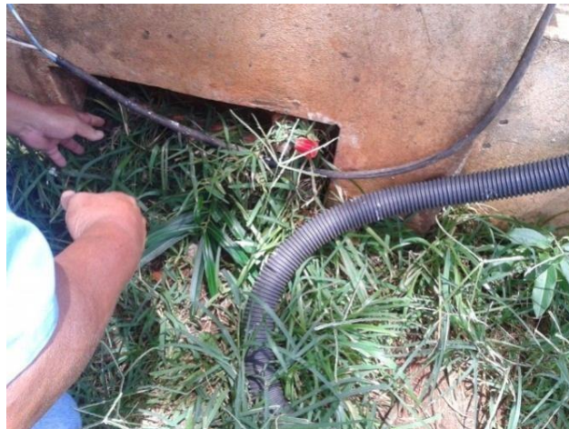
Figura 12: Única torneira de água ativa.
