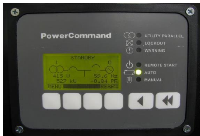
Figura 5-1: Painel do Quadro de Transferência Automática.
