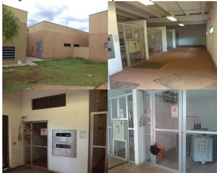
Figura 3-1: Fotos da Subestação do Hospital Universitário.
