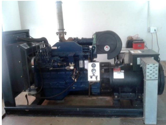
Figura 3-2: Grupo Moto-Gerador principal.
