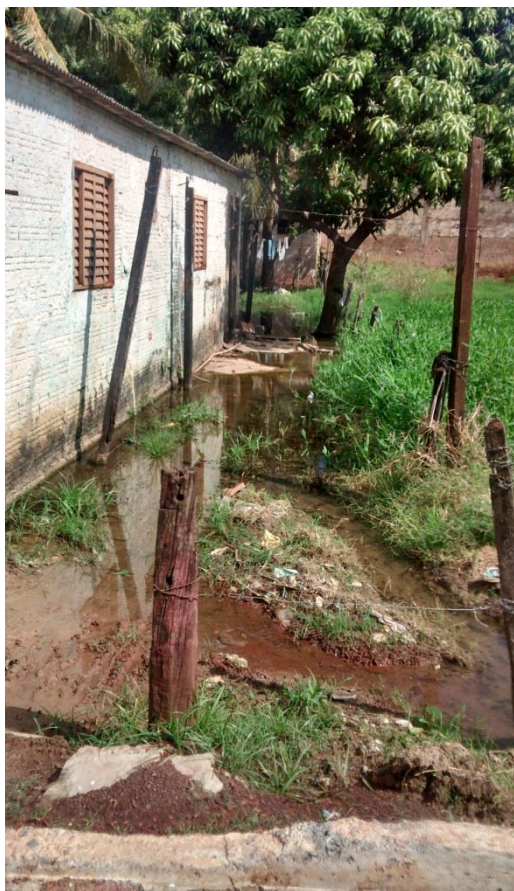
APÊNDICE A – Moradia sujeita a alagamento. Corumbá – MS, 2014.
