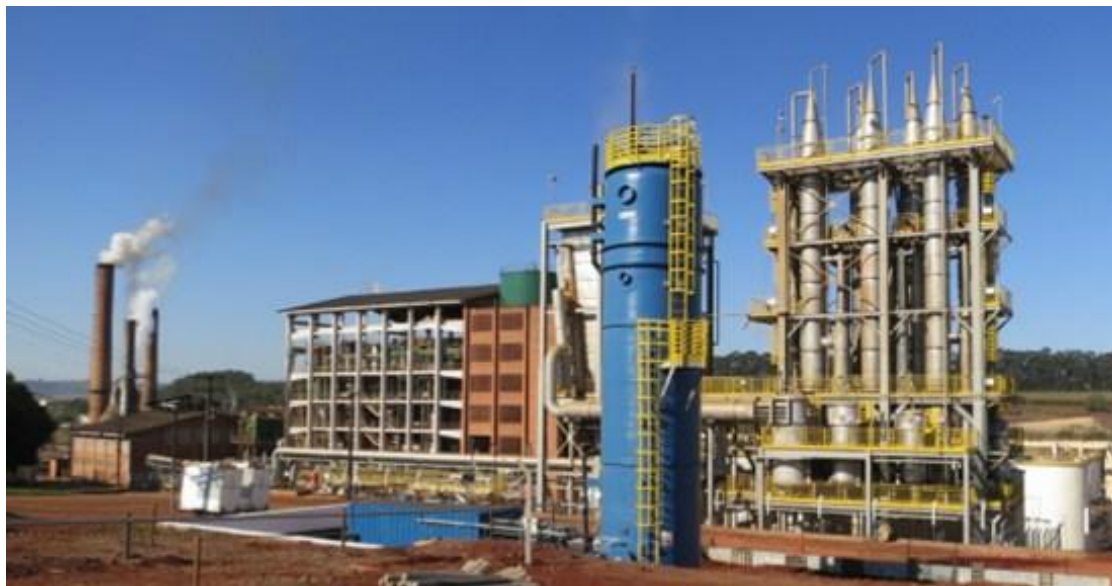
Figura 16: Reator de demonstração IC da empresa BIPAQUE ®ICX instalado em destilaria no Brasil.
