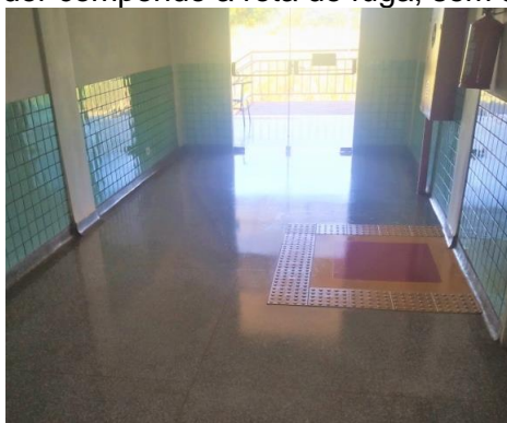
Figura 9 - Corredor compoendo a rota de fuga, sem a sinalização tátil
