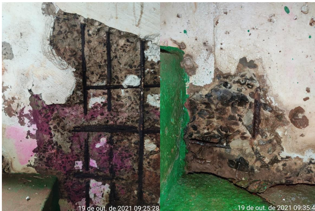
Figura 02- Exposição de armaduras
