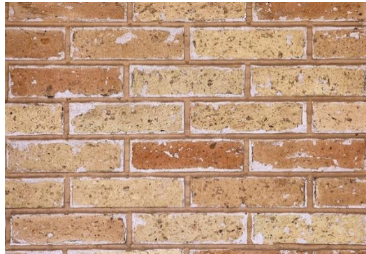
Figura 7 – Eflorescência em parede de alvenaria.
