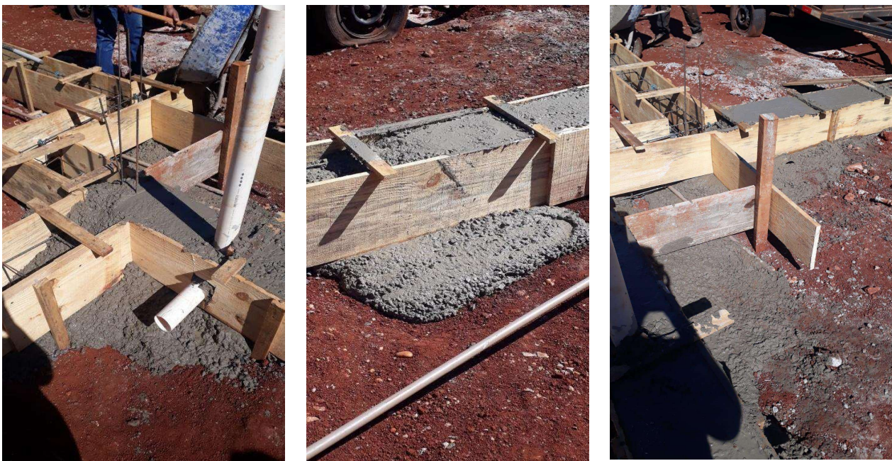
Figura 6 – Imagens do desperdício na concretagem das vigas baldrame.
