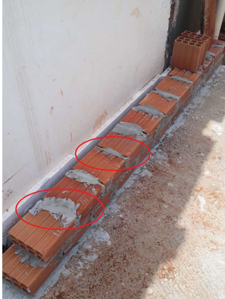
Figura 5 - Desconformidade das juntas.
