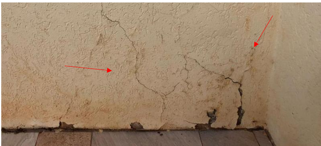
Figura 16: Infiltração área externa
