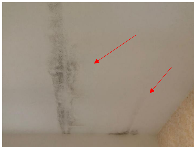
Figura 21 – Detalhe do Mofo e bolor no teto sala
