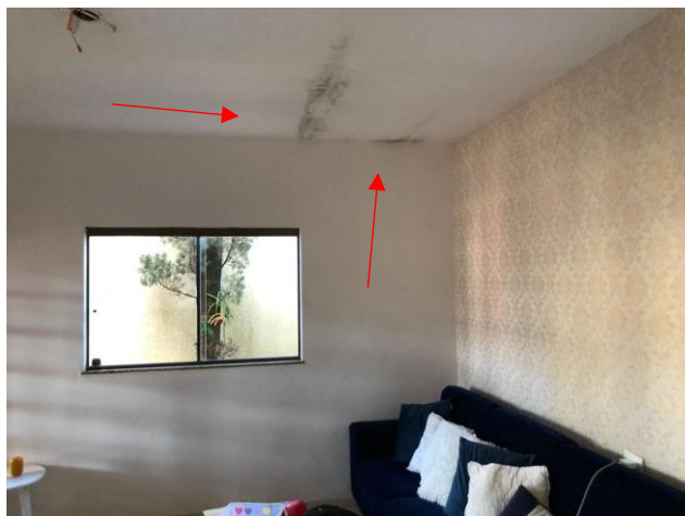
Figura 20 – Mofo e bolor na sala
