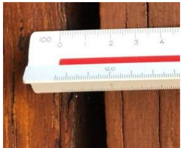
Figura 11 – Detalhe rachadura pilar
