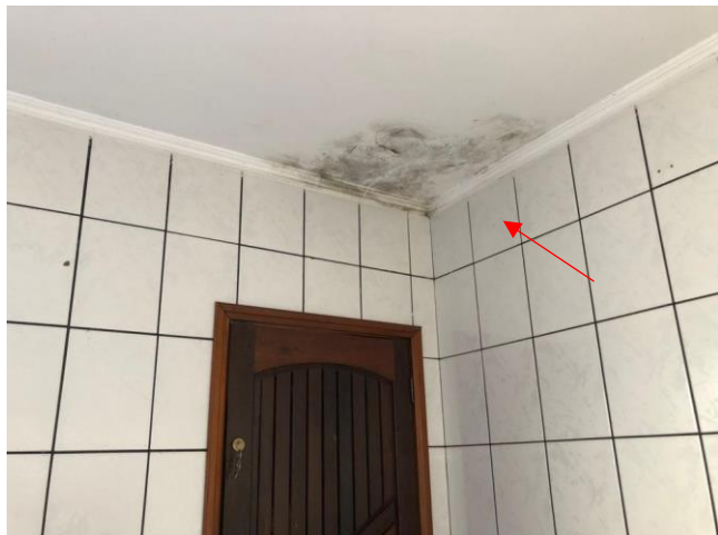
Figura 17 - Mofo teto cozinha
