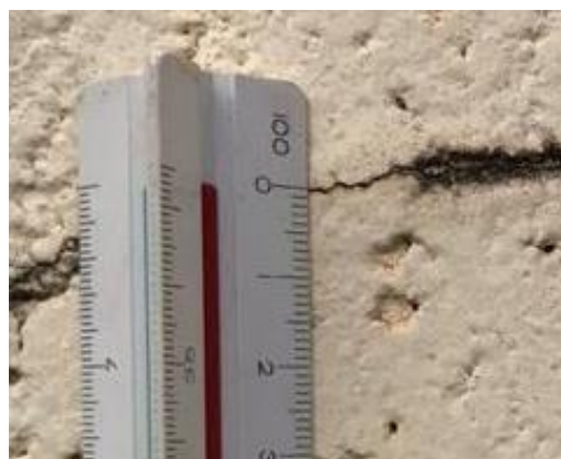
Figura 4 – Fissura 0,5 mm na parede externa
