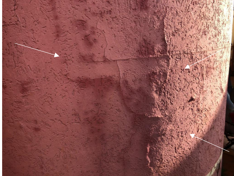
Figura 15 - Infiltração parede banheiro
