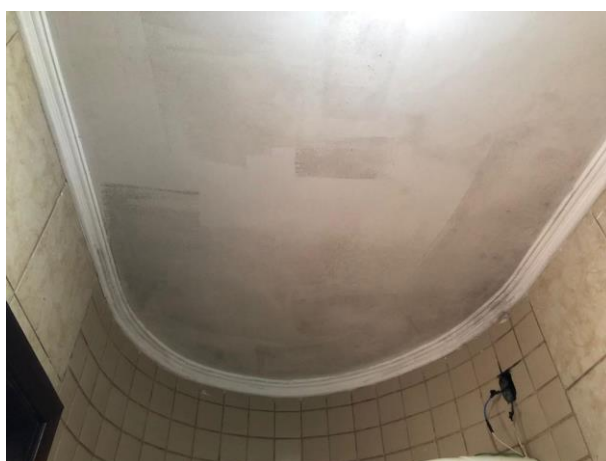
Figura 19 - Mofo teto banheiro
