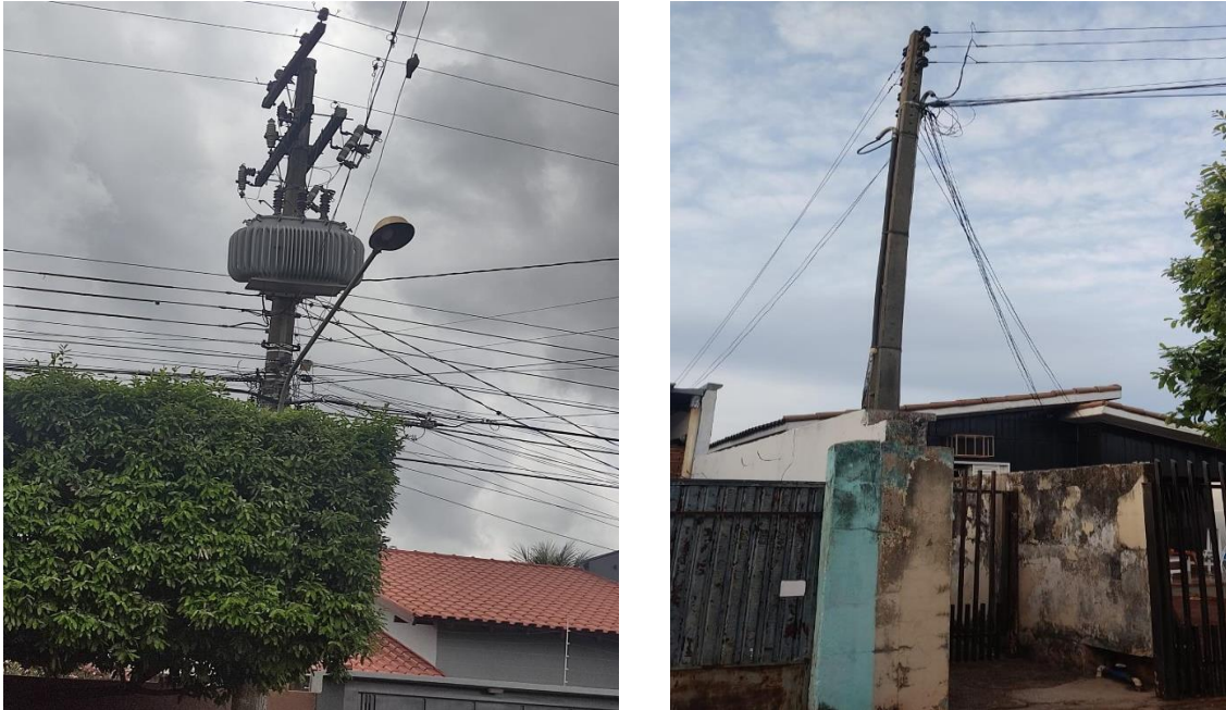
Figura 52 – Transformador e padrão de entrada do Estudo de Caso 01
