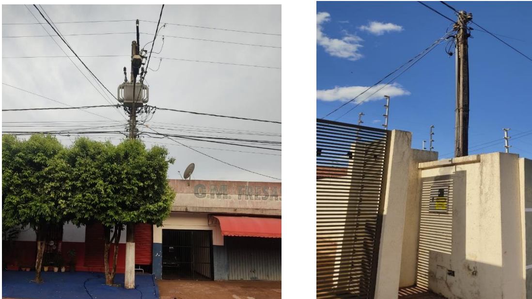
Figura 60 – Transformador e padrão de entrada do Estudo de Caso 02
