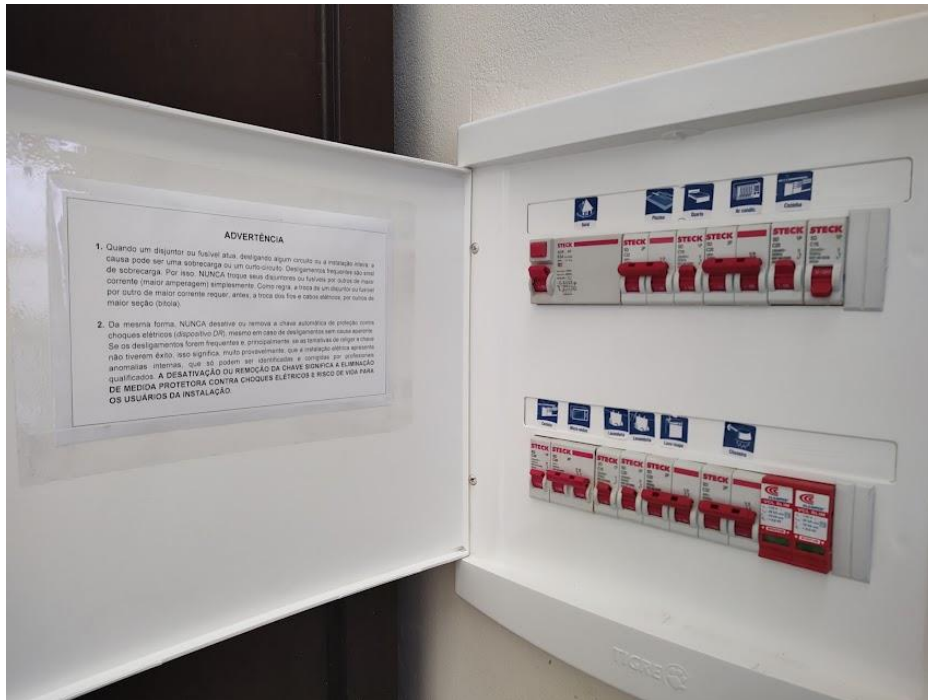
Figura 71 – Advertência fixada no quadro de distribuição do Estudo de Caso 03
