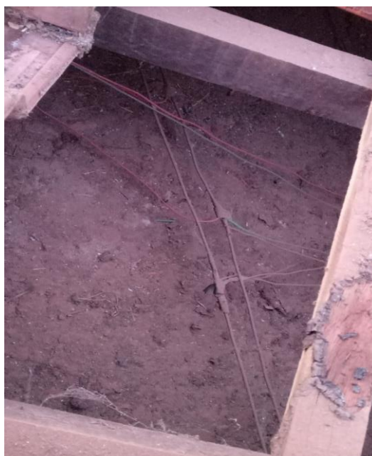
Figura 51 – Rede de alimentação mestre da residência do Estudo de Caso 01
