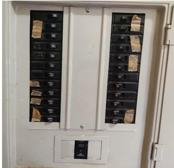
Figura 59 – Quadro de distribuição do Estudo de Caso 02
