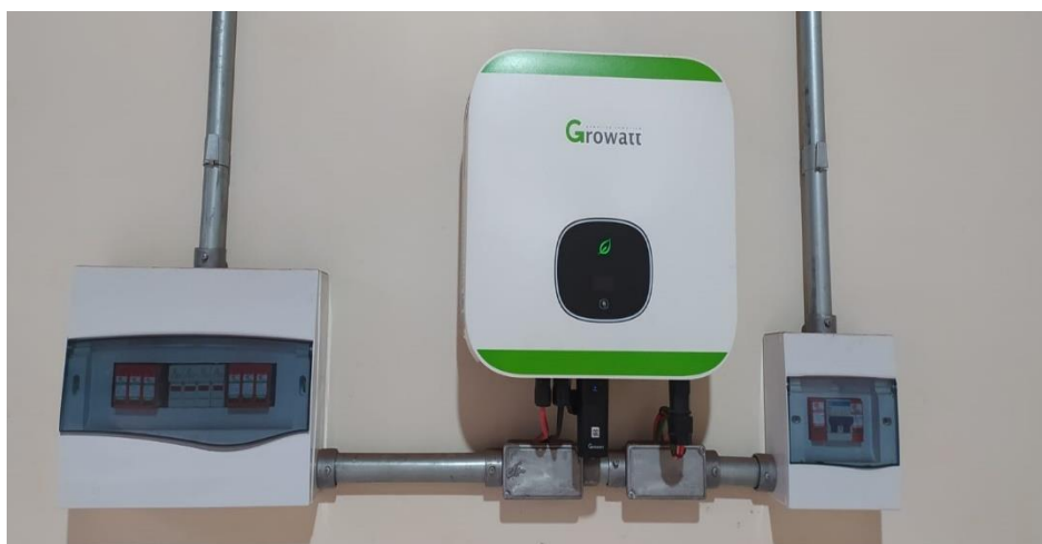
Figura 5: Inversor instalado junto com o quadro de proteção
