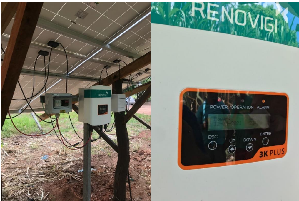
Figura 19. Inversor Renovigi instalado.
