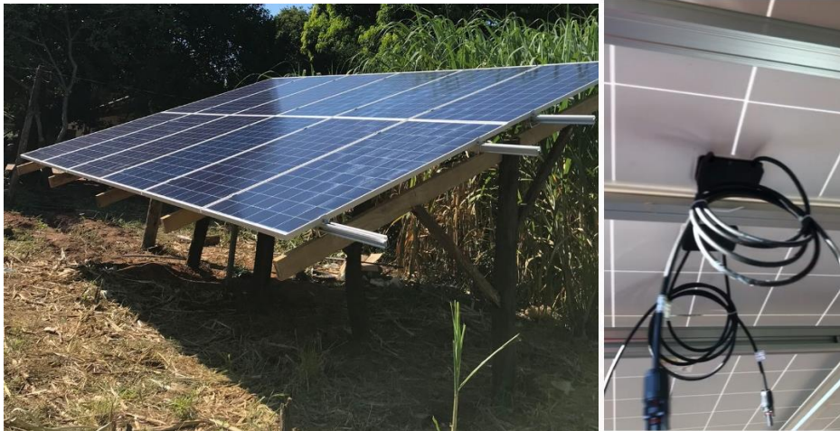
Figura 18. Módulos fotovoltaicos instalados.
