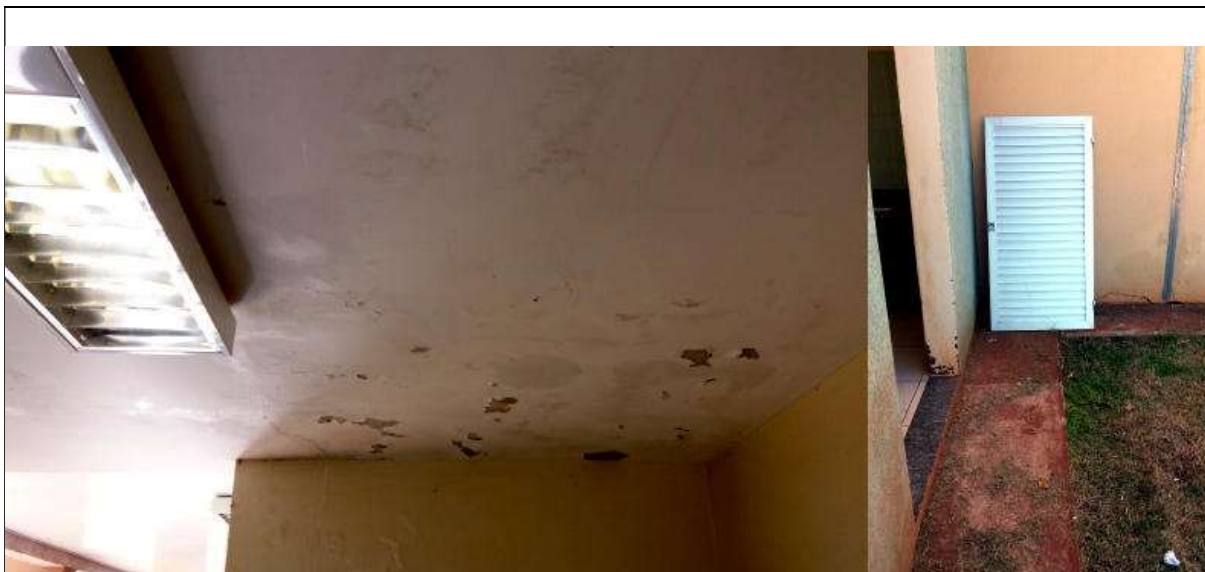
FOTOGRAFIA 6: Estrutura, fissuras, infiltrações, pedaços soltos e abandonados, em 02 de julho de 2016, as 13h28.
