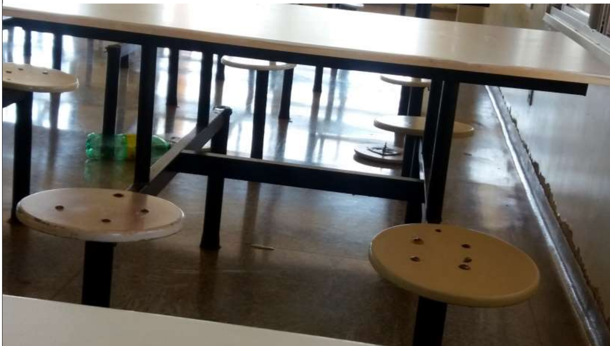
FOTOGRAFIA 5: No chão, lixo e banco quebrado, 10 de agosto de 2016, 08h46.
