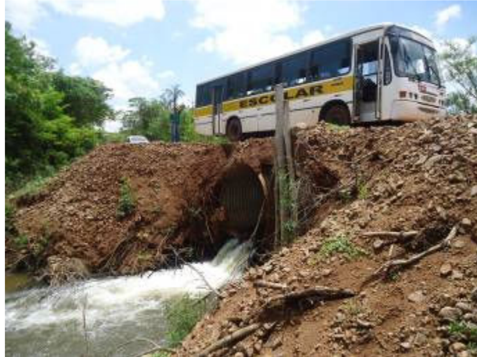
Figura 9 – Erosão em ponte que corta córrego da região, Fonte: Arquivos do autor (2014).
