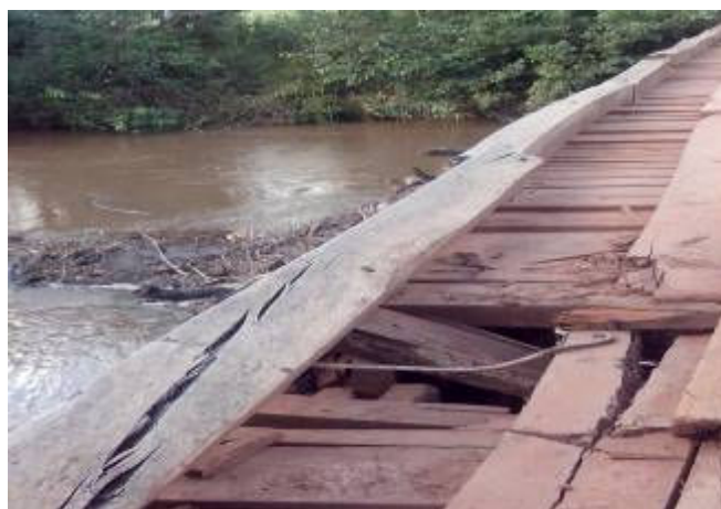
Figura 14 – Ponte de acesso à escola do campo defeituosa. Fonte: Arquivos do autor (2014).
