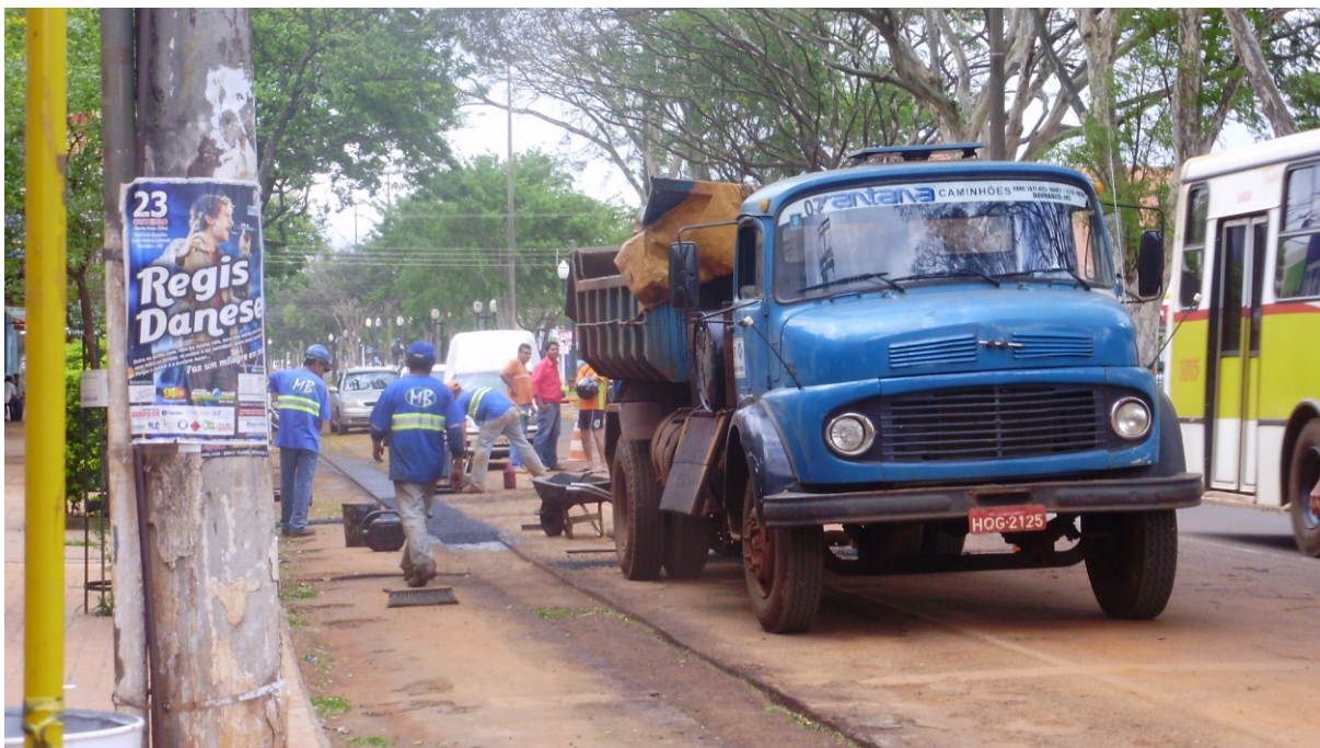
Foto 22 – Obras no sistema de abastecimento de água na Av. Marcelino Pires, área central de Dourados
