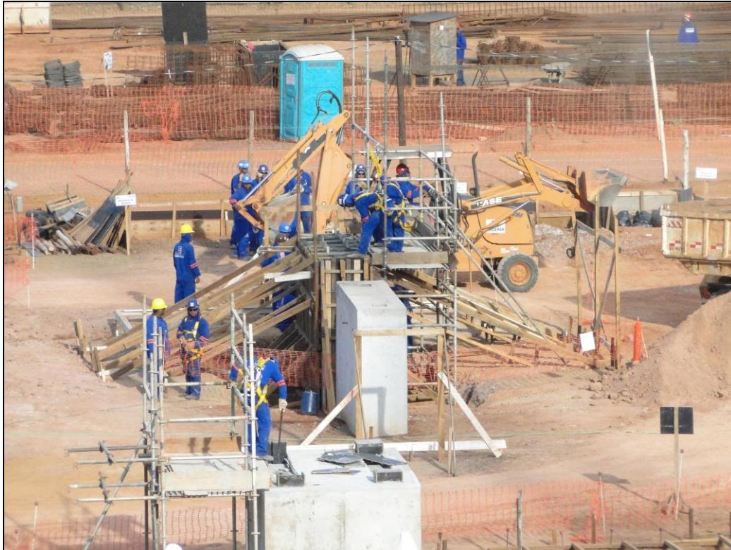
Figura 22 - Trabalhadores da construção civil no canteiro de obras da fábrica da Eldorado em Três Lagoas Autor: Tayrone Roger A. Asevedo. (04/2012).
