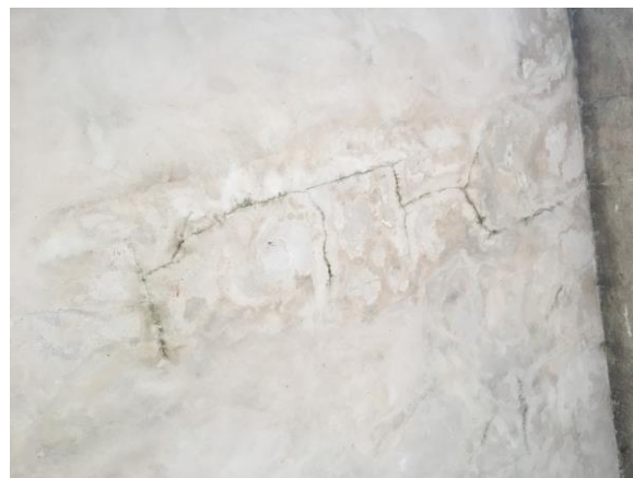
Figura 7. Trincas aparentes em uma das lajes.
