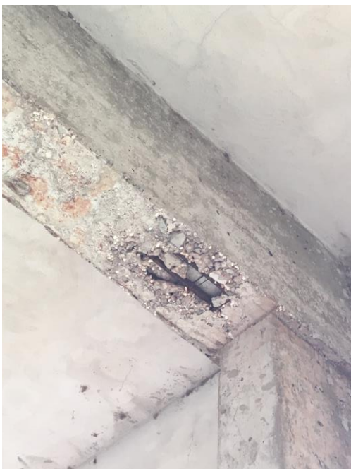
Figura 6. Viga com suas armaduras expostas.
