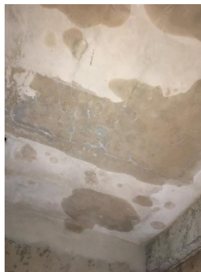
Figura 8. Laje de cobertura com infiltração.
