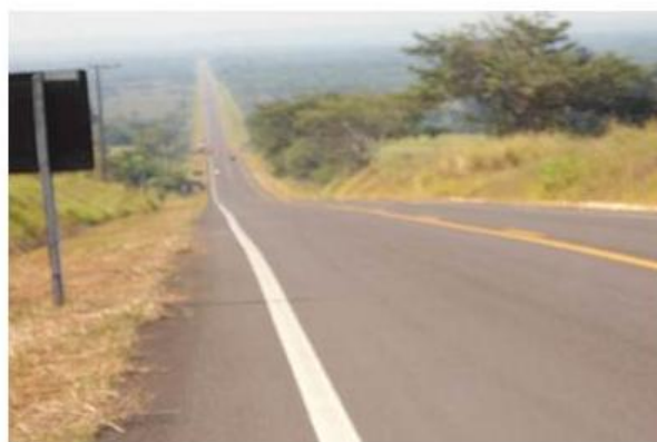
MS-040 depois da colocação da cobertura asfáltica em seu trecho final. Fonte: Katia Kyahara da Silva, 2008.
