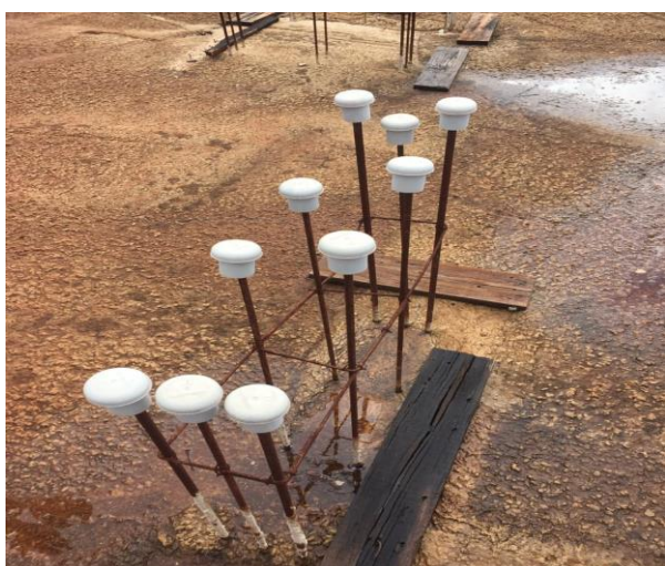
Figura 13. Proteção nas pontas dos vergalhões da empresa B.
