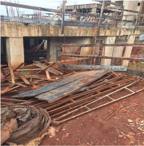
Figura 6. Estocagem inadequada das sobras de materiais da empresa B.
