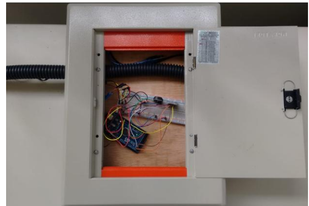
Figura 7. Sistema de Monitoramento de Temperaturas instalado.
