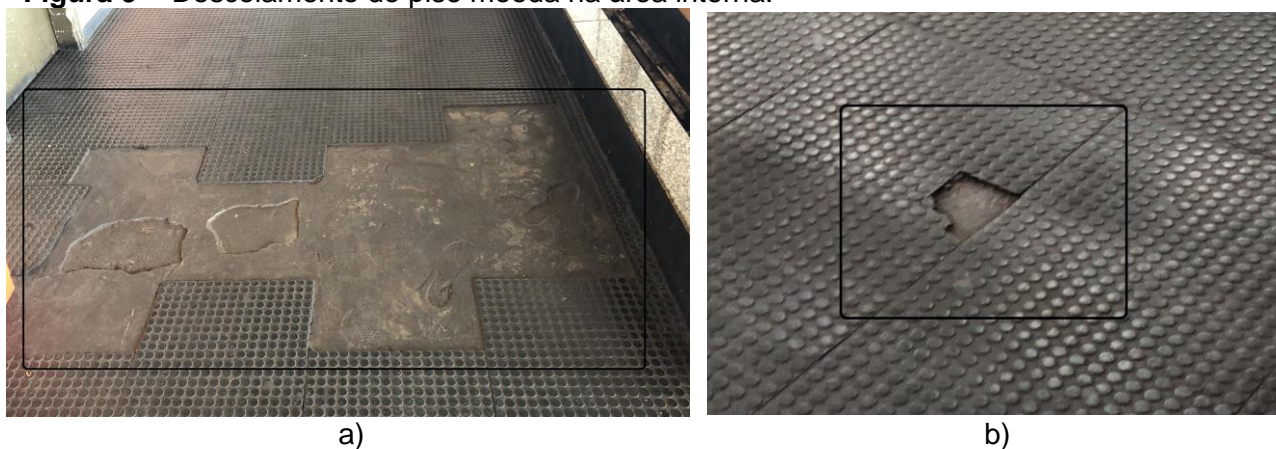
Figura 9 - Descolamento do piso moeda na área interna.
