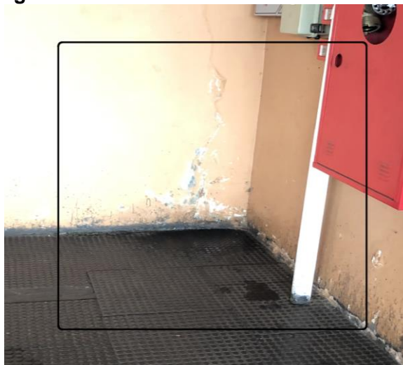
Figura 3 - Manchas e bolores na área interna
