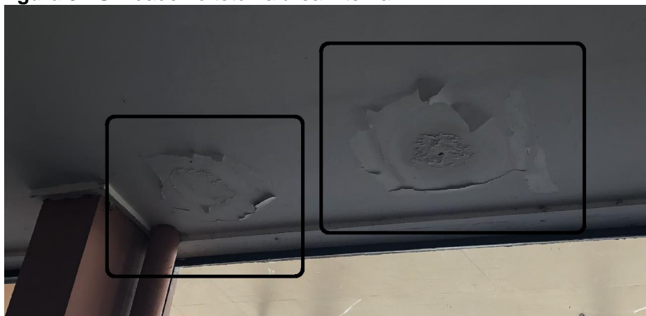
Figura 5 - Umidade no teto na área interna
