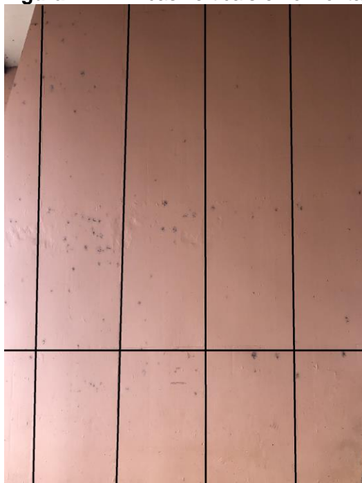
Figura 11 - Trincas verticais e horizontais na parede
