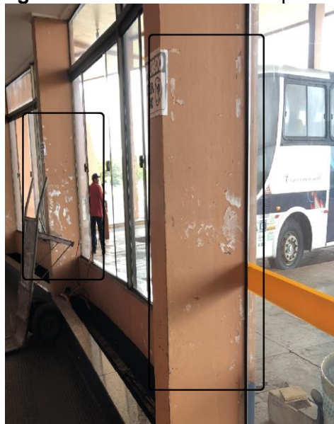
Figura 8 - Descolamento com pulverulência.
