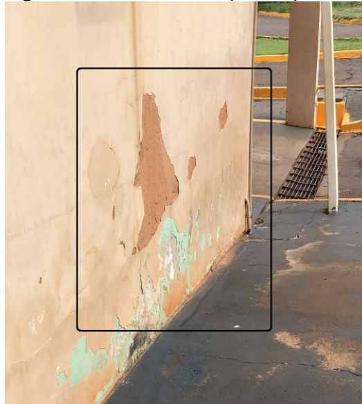
Figura 7- Descolamento por empolamento na área externa
