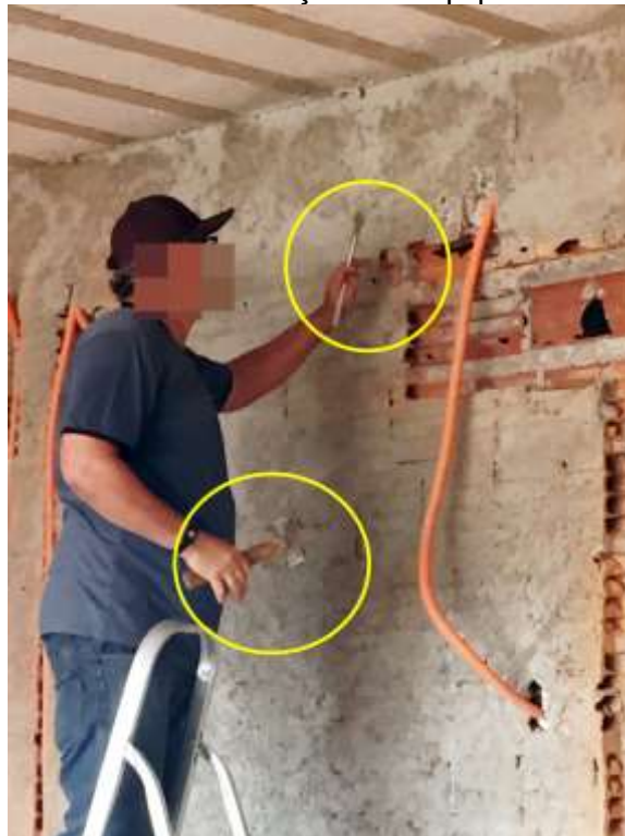
Figura 8 – Abertura de dutos sem a utilização dos equipamentos de proteção individual.
