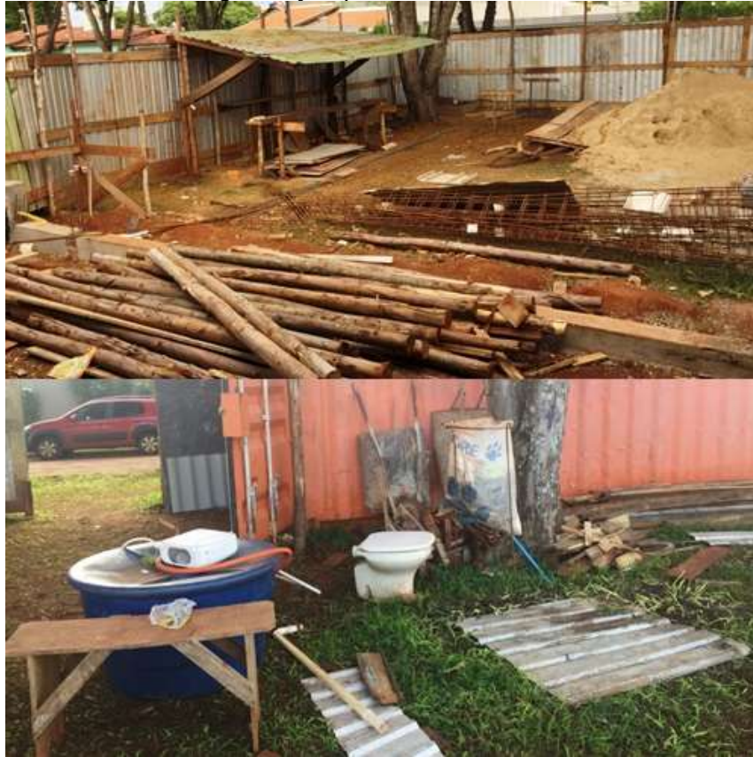
Figura 3- Organização precária do canteiro de Obras.
