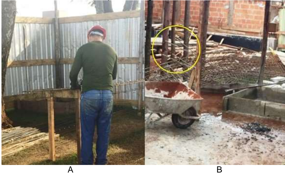
Figura 4-A: área destinada à corte e dobra de armaduras desprotegida. Figura 4-B: vergalhões dispostos irregularmente.
