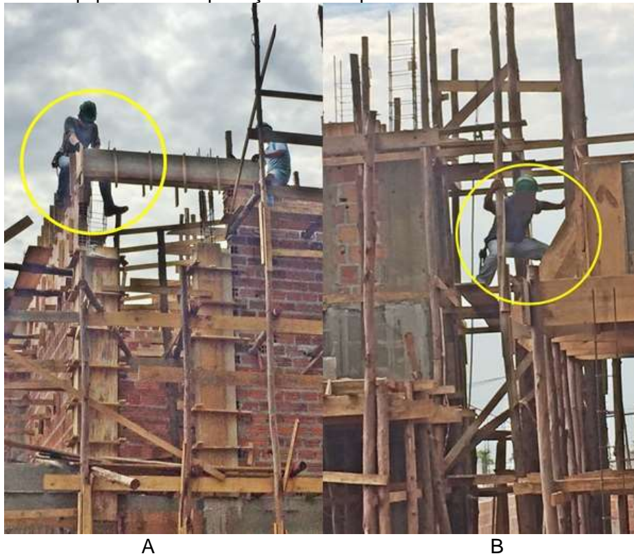
Figura 6-A: A Falta de guarda corpo para a proteção coletiva dos trabalhadores. Figura B: A não utilização de equipamento de proteção contra queda em altura ao escalar as escoras.
