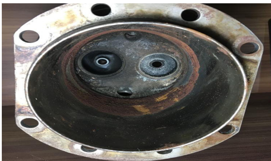
Figura 18. Cilindro apresentando corrosão, vista do interior. Fonte: O Autor, 2017.
