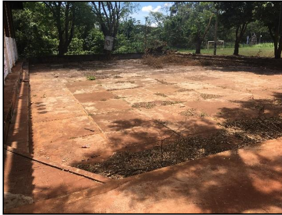
Imagem 08: Falta de manutenção na quadra descoberta
