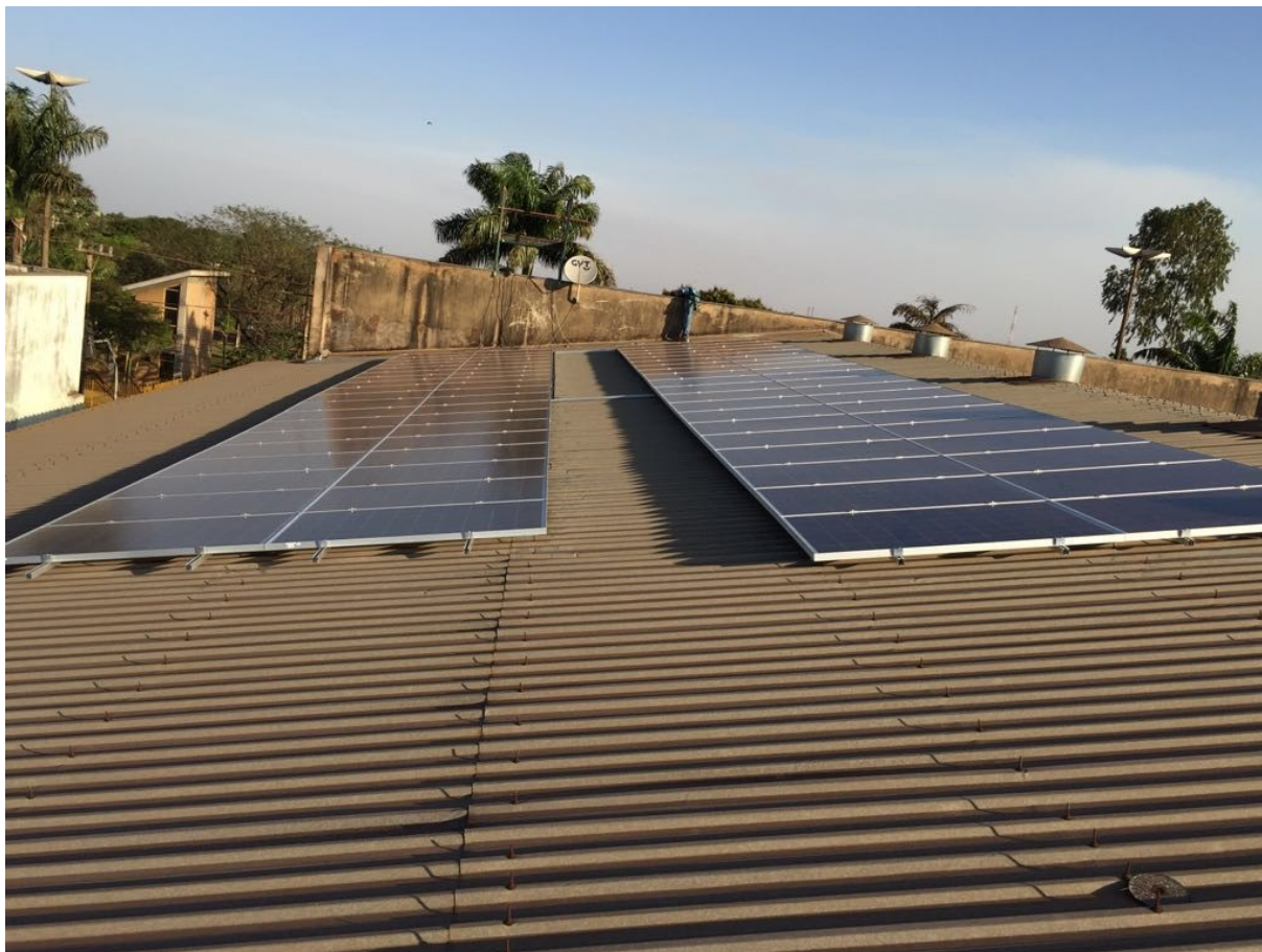
Figura 20 - Arranjo fotovoltaico instalado
