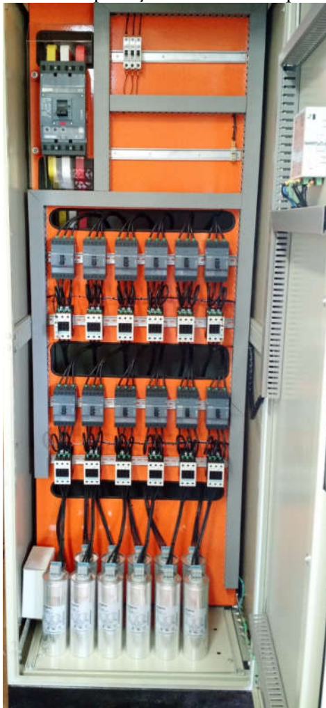
Figura 17 – Novo quadro de comando elétrico, onde se encontram os equipamentos de acionamento e proteção das células capacitivas.
