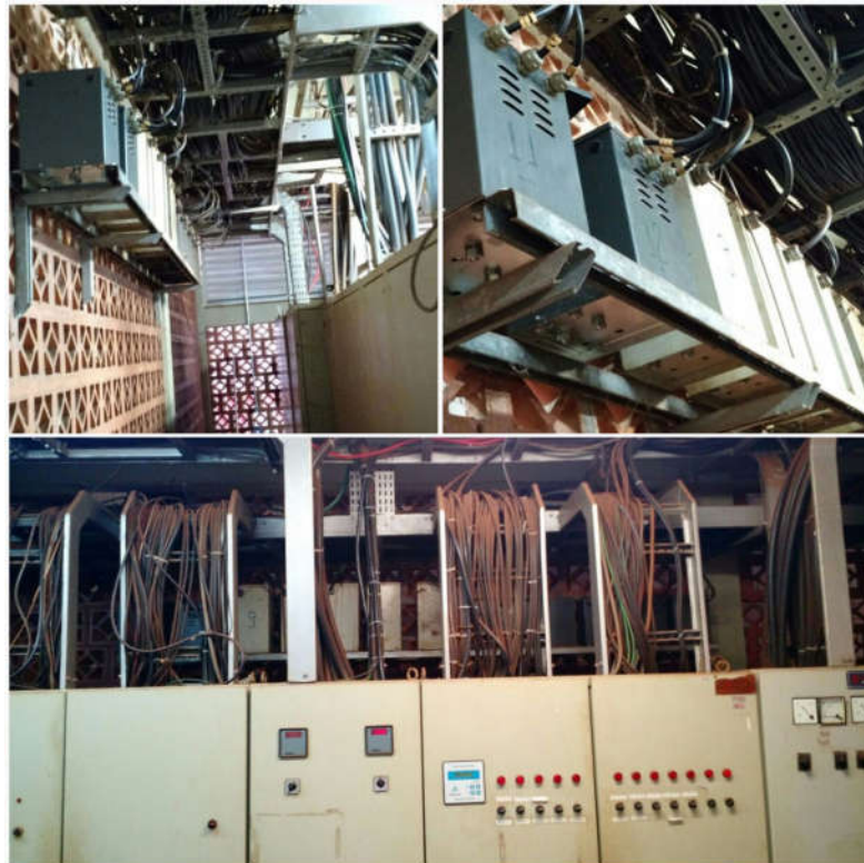
Figura 14 – Condições atuais da instalação do banco de capacitores.
