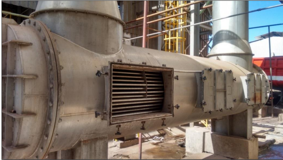
Figura 24 – Trocador de calor casco tubo aberto para observação da posição dos tubos (Fonte: Elaborada pelo autor, 2016).
