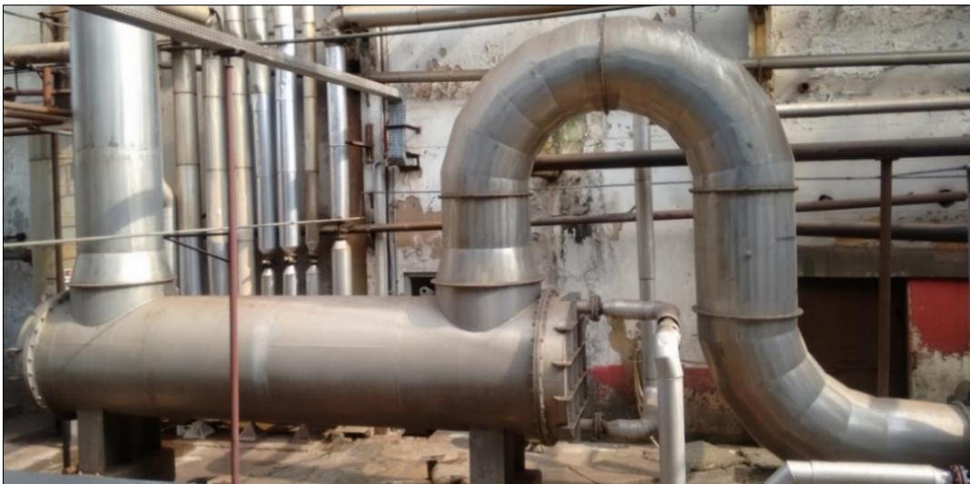
Figura 23 – Trocador de calor casco tubo instalado (Fonte: Elaborada pelo autor, 2016).
