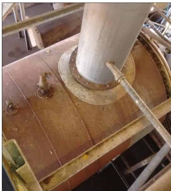
Figura 20 – Duto instalado na parte superior do digestor de vísceras para a captação dos gases/vapor de exaustão (Fonte: Elaborada pelo autor, 2016).
