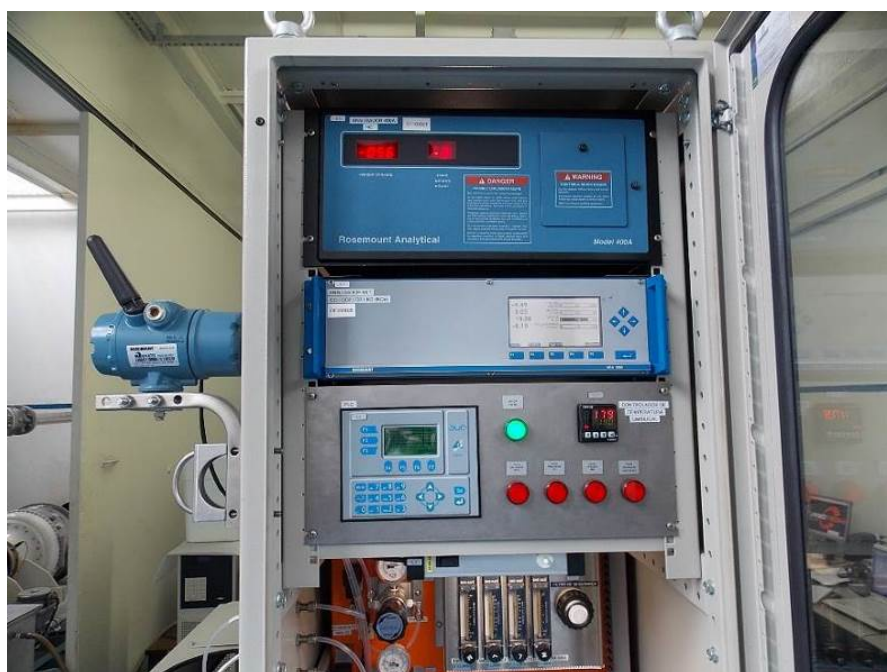
FIGURA 4.3 – Rack com os módulos
