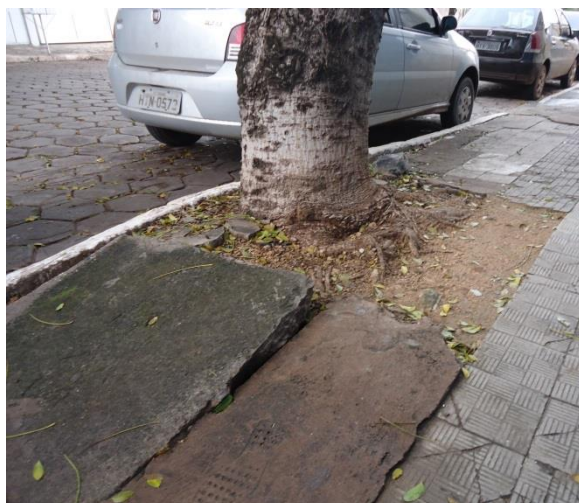
Figura 41: O crescimento das raízes provocou o desnivelamento da calçada, comprometendo sua acessibilidade para os pedestres. Fonte: Oficinas de Cidadania Participativa. Data: maio/2014.
