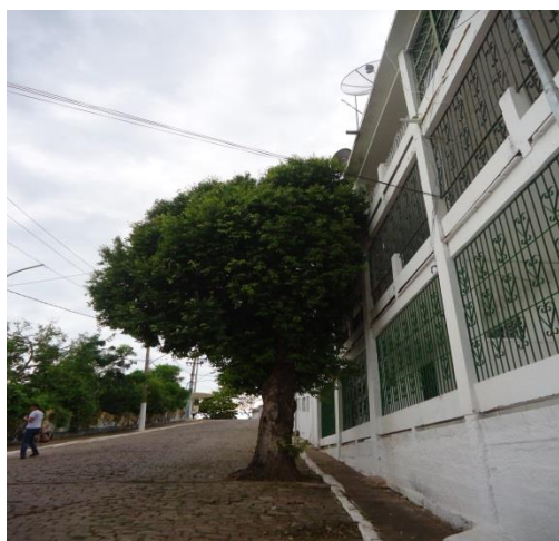
Figura 37: Copa da árvore em conflito com a fachada do imóvel. Fonte: Oficinas de Cidadania Participativa. Data: maio/2014.
