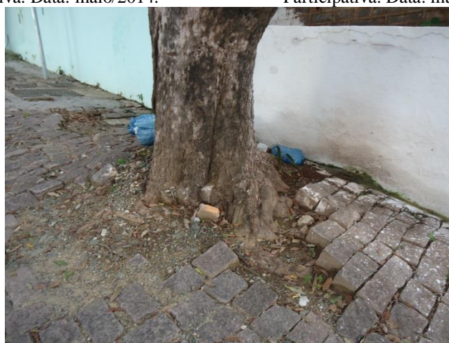
Figura 43: O crescimento das raízes provocou o desnivelamento do pavimento. Fonte: Oficinas de Cidadania Participativa. Data: maio/2014
