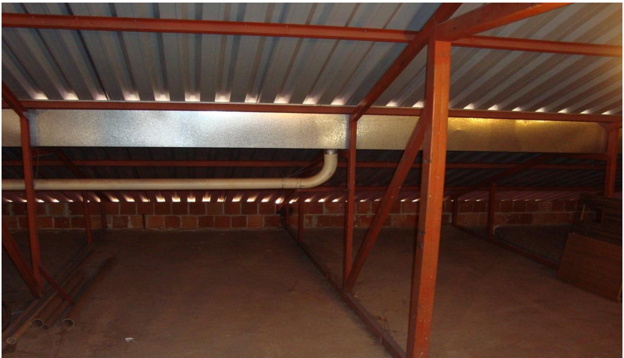
Figura 14: Área de captação, calha e tubulação.
