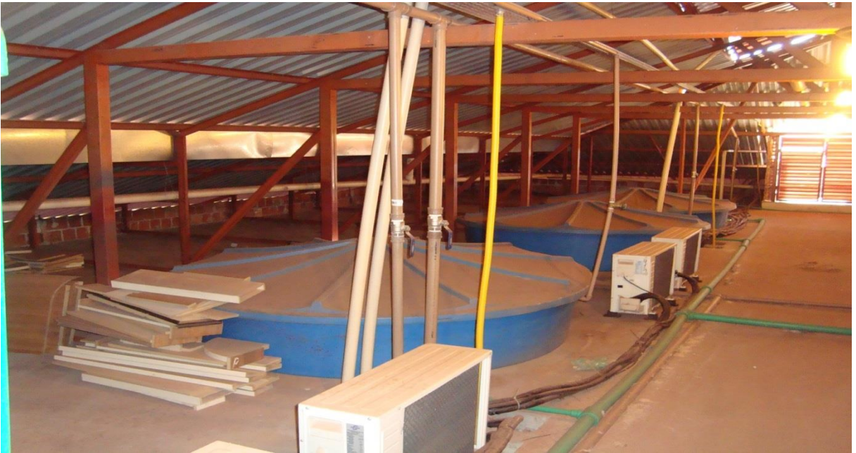
Figura 15: Área de captação, calha, tubulações e reservatórios.
