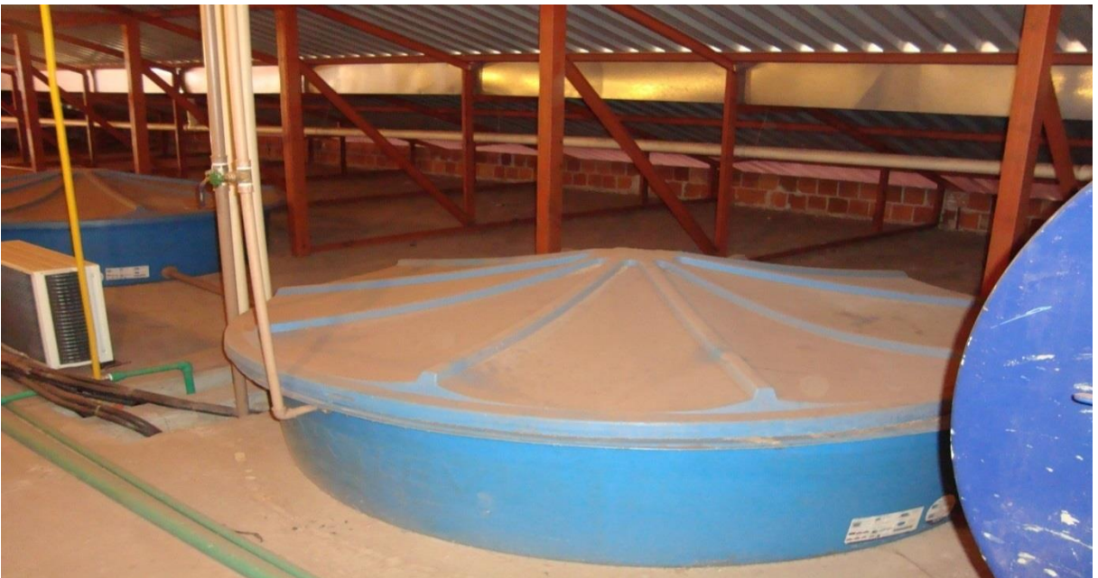
Figura 16: Reservatório de 1000 litros de capacidade.
