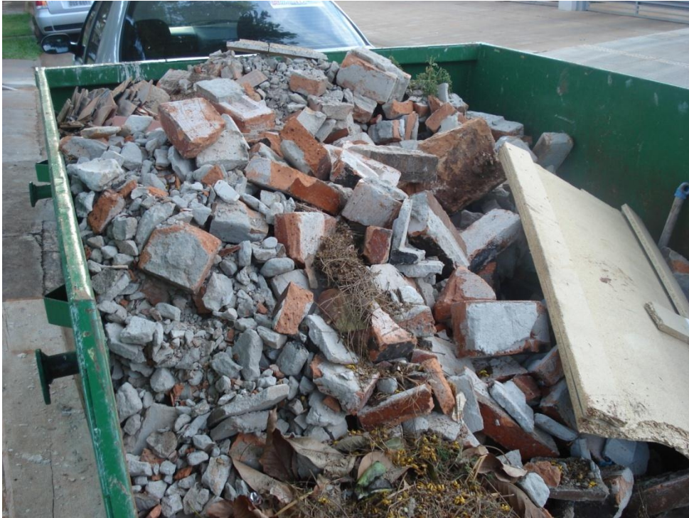
Resíduos em obras 3: Rua Fernando Costa da Lima. Fonte: Pesquisa de campo.
