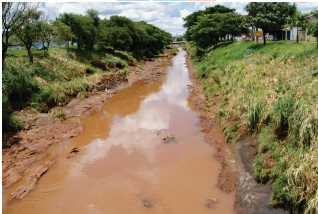
Rio Anhanduí apresenta problemas de erosão e tem previsão de obras de contenção para este ano. (Foto: Elvio Lopes)
