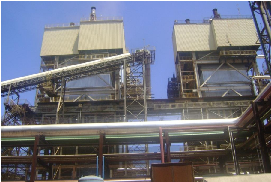
Figura 8. Caldeiras para geração de vapor para produção de energia. Fonte: Autor.
