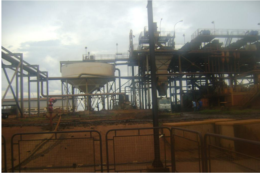
Figura 9. Estação de Tratamento de Água de Lavagem de Gases e filtro prensa. Fonte: Autor.
