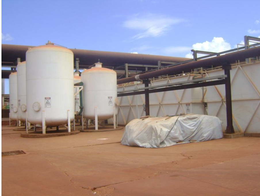
Figura 41. Sistema de Tratamento de Água da Usina, à esquerda as três linhas fechadas e a direita as duas linhas abertas.
