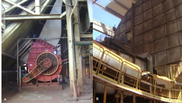
Figura 37. A) Soprador do sistema de lavagem a seco da cana de açúcar. B) Lavador a seco da cana de açúcar.
