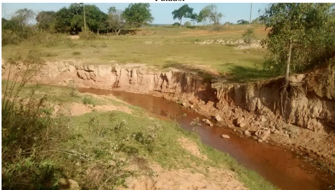
Foto 6 – Município de Anastácio Processo de assoreamento e erosão em trecho do Córrego Pulador, localizado na Colônia Pulador
