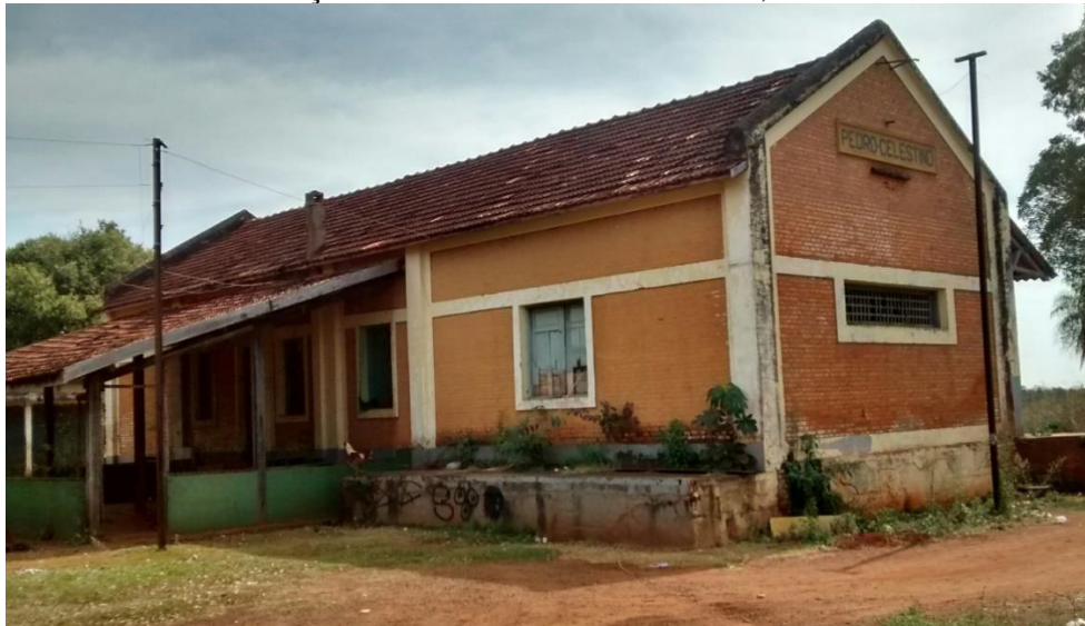
Foto 7 – Município de Terenos Prédio abandonado da Estação Ferroviária Pedro Celestino, localizado na Colônia Jamic
