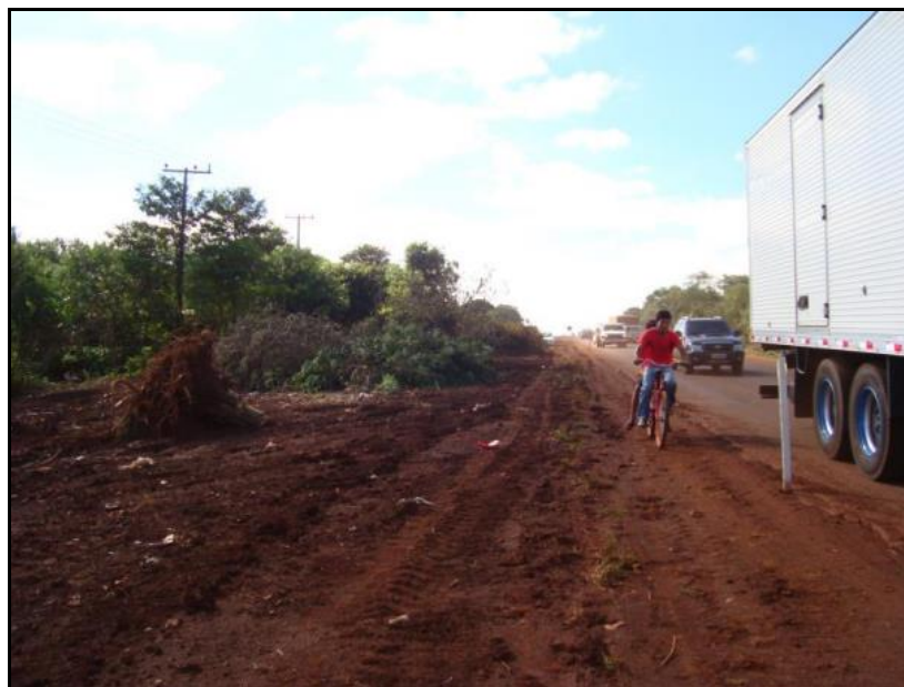
Figura 21 – Fotografia retirada em 2010 que mostra vegetação suprimida durante as obras de reordenamento do tráfego da Rodovia MS-156 (PEREIRA, 2014, p. 6)
