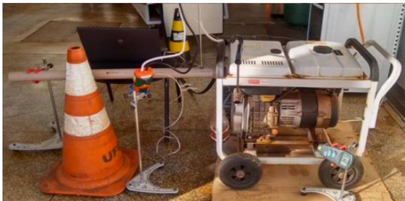
Figura 1 – Conjunto motogerador utilizado durante os ensaios
