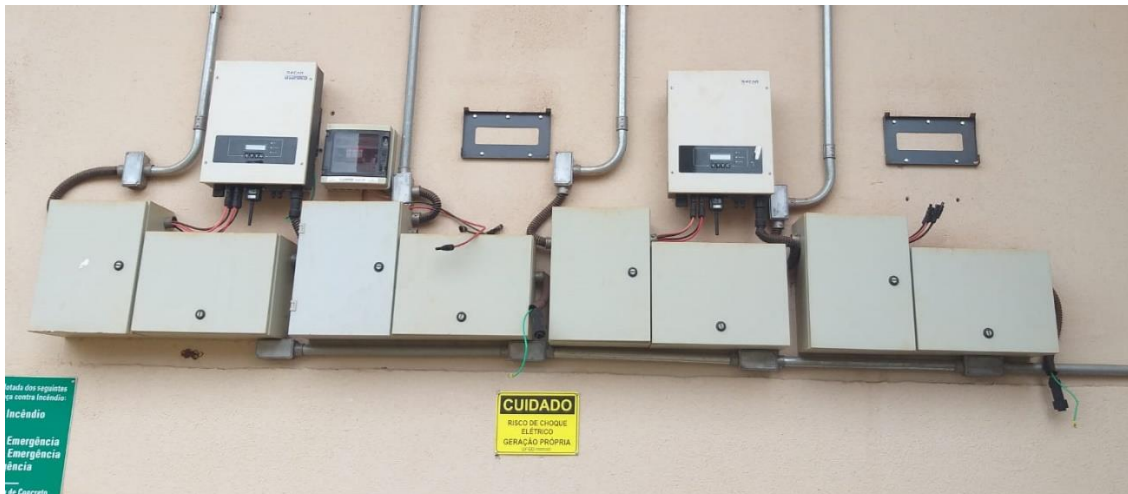
Figura 24 – Conjunto de inversores do sistema fotovoltaico do bloco FAEN em 2022.
