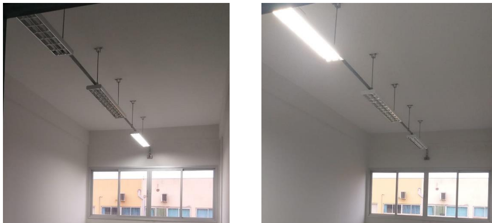
Figura 21 – Iluminação com circuito separado para as lâmpadas próximas às janelas para o aproveitamento da luz natural.
