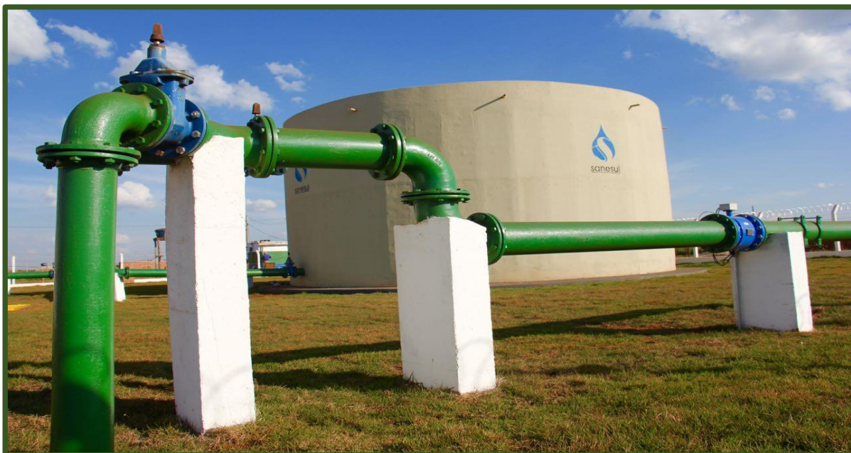
FIGURA 4 – RESERVATÓRIO SANESUL DE ÁGUA na sede do Assentamento Itamarati
