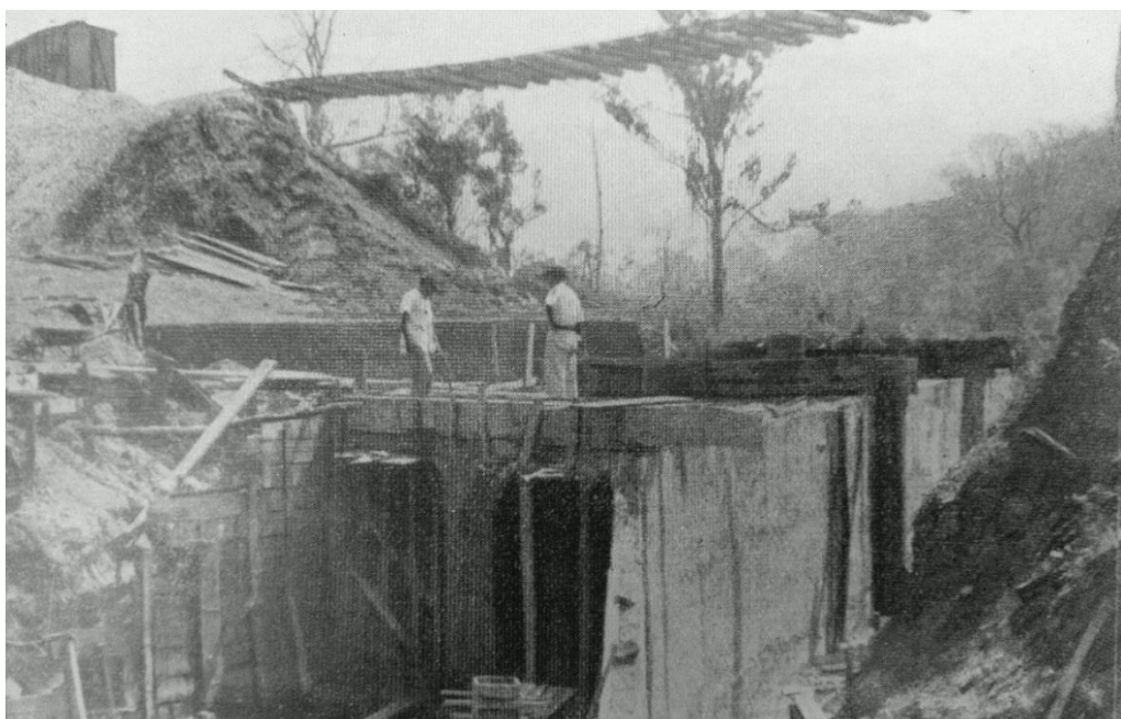
Figura 16: Terraplanagem destruída por um turbilhão no km 297, na Bolívia
