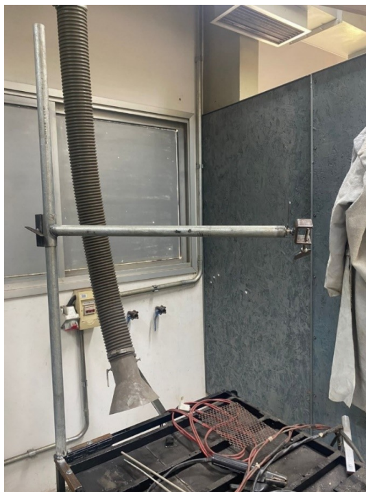
Figura 13. Dispositivo concluído Fonte: Acervo do autor (2023).
