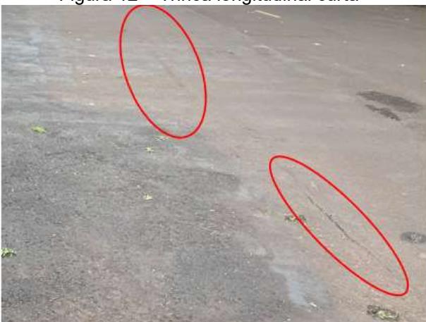
Figura 12 – Trinca longitudinal curta
