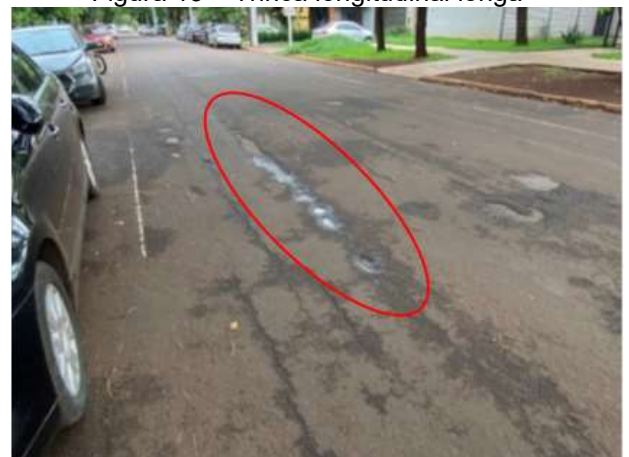
Figura 13 – Trinca longitudinal longa
