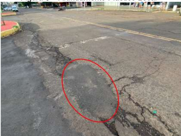
Figura 6 – Afundamento Plástico Local
