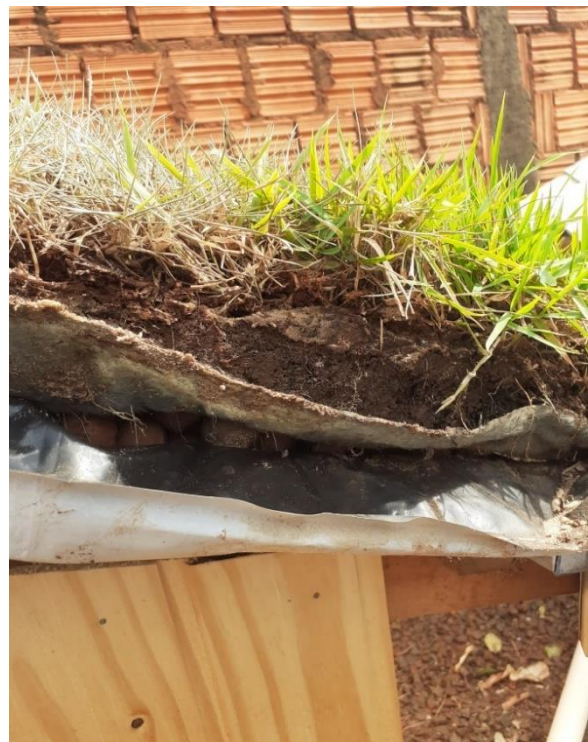
Figura 14 – Patologia: leve compactação do substrato
