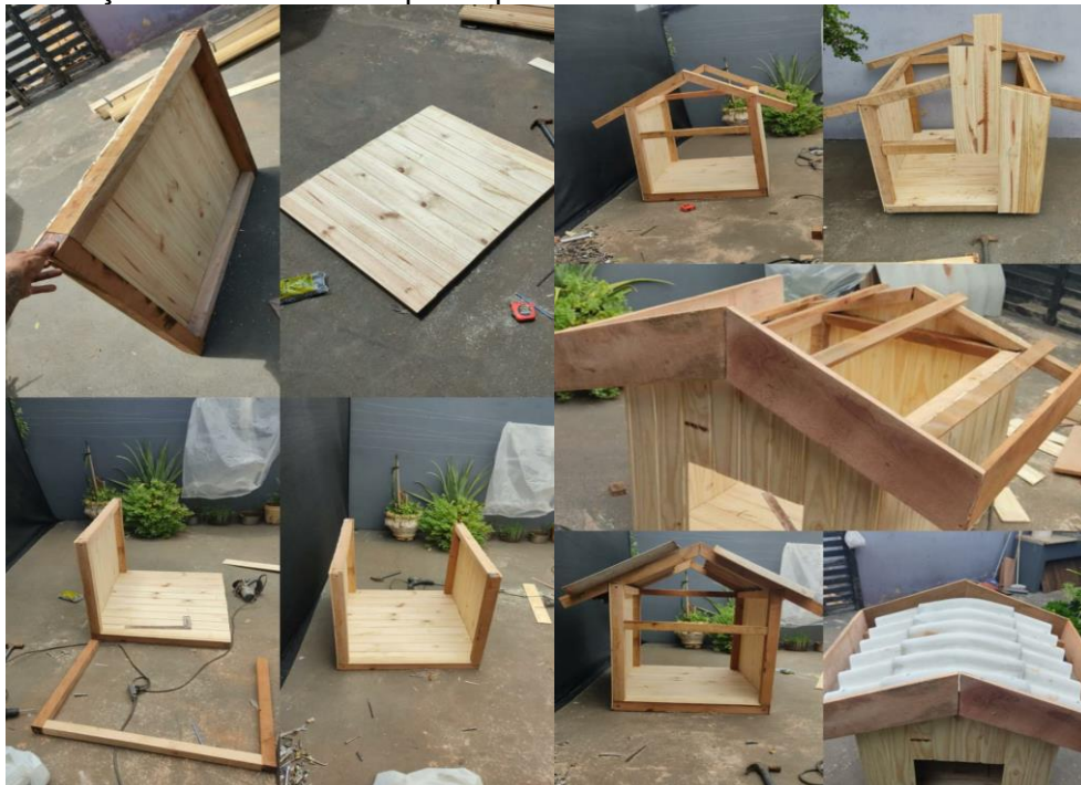
Figura 5 – Execução da estrutura dos protótipos de telhado com de fibrocimento e telhado verde
