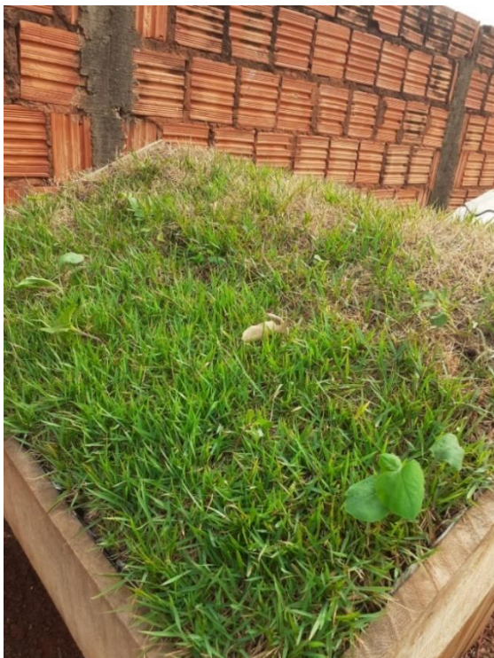
Figura 13 – Patologia no surgimento de ervas daninhas
