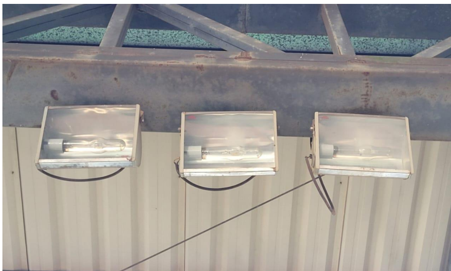
Figura 12 - Luminária VM atual da quadra poliesportiva - UFGD
