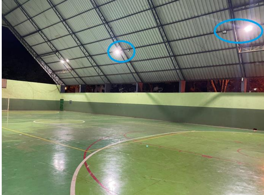
Figura 22 – Luminárias defeituosas atuais na quadra poliesportiva - EERV
