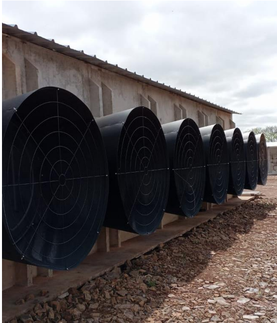
Figura 7 - Exaustores dos aviários de Toledo – PR.
