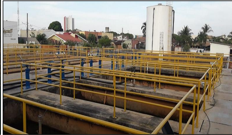
Imagem 7 – Estação de tratamento e distribuição de águas
