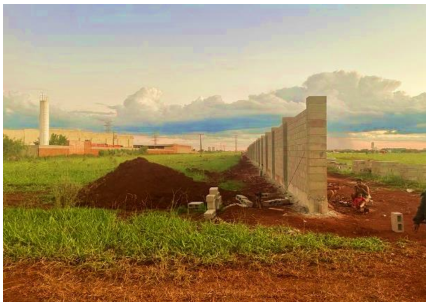
Figura 37: Muro de condomínio sobreposto às retomadas
