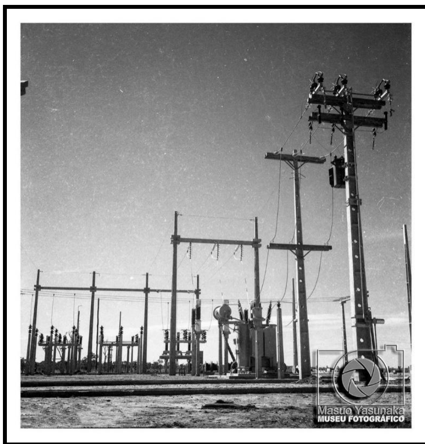
Fotografia 28: Subestação de Fátima do Sul inaugurada em 1973
