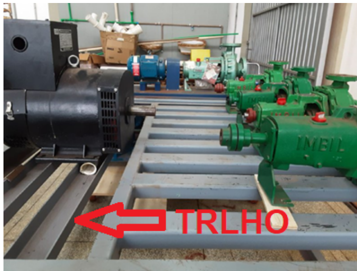
Figura 16 – Alinhamento paralelo das BFTs e distância entre os eixos das bombas e do alternador.
