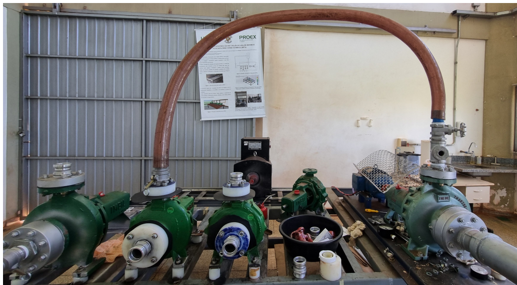
Figura 46 – Sistema de recalque com mangueira reforçada acoplado à BFT de 4 cv.
