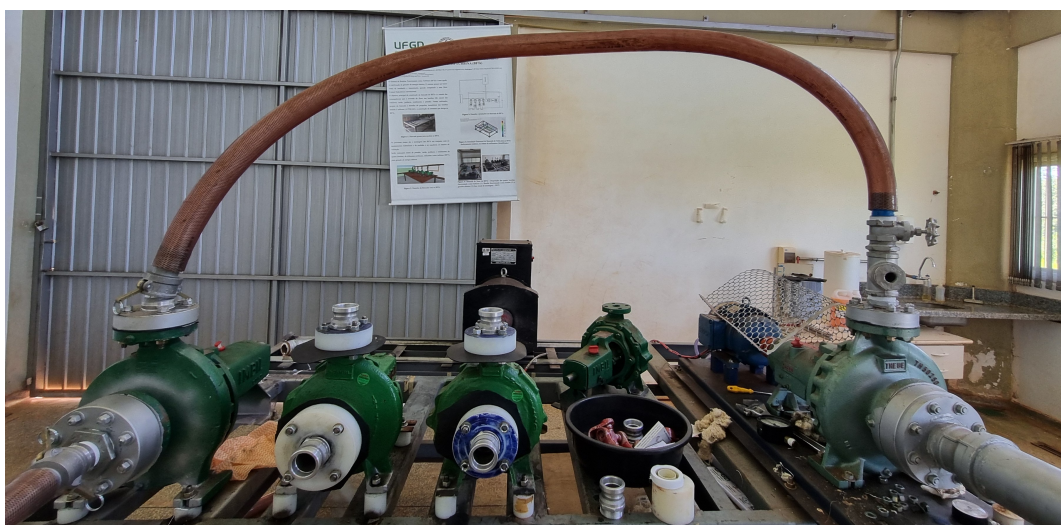
Figura 47 – Sistema de recalque com mangueira reforçada acoplado à BFT de 6 cv.
