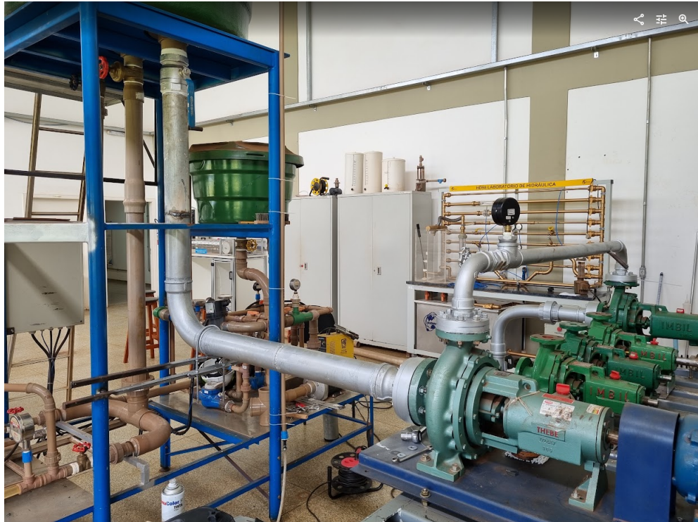
Figura 42 – Sistema hidráulico acoplado ao reservatório e à linha de recalque da bancada.
