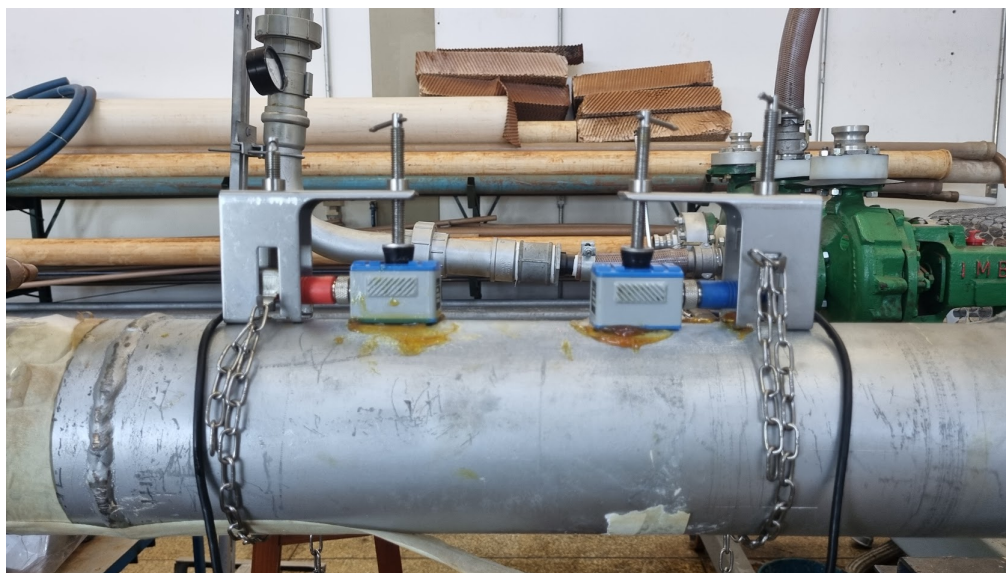
Figura 52 – Montagem do medidor ultrassônico portátil CAM-3000H na tubulação de sucção da bancada.
