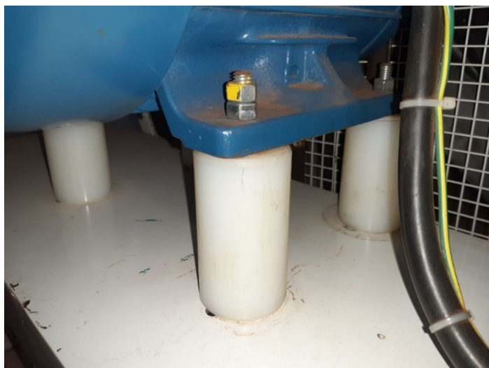
Figura 25 – Exemplo de bloco de tecnil considerado para ajuste de altura das BFTs em relação ao eixo do alternador.
