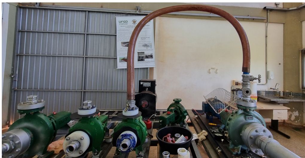
Figura 45 – Sistema de recalque com mangueira reforçada acoplado à BFT de 2 cv.
